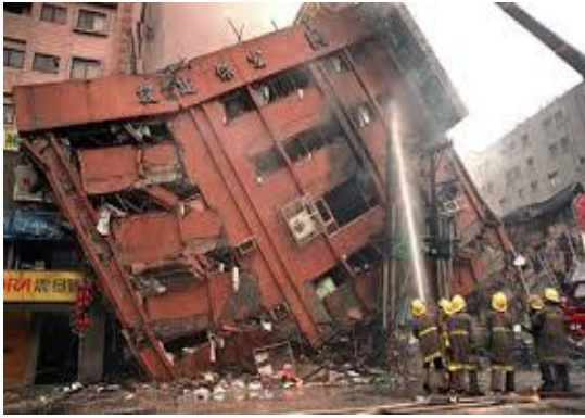
圖片說明：921 大地震房屋倒塌 資料來源：Google 圖片
